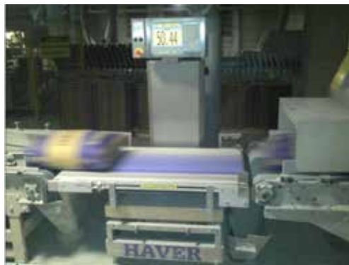
Figura 5. Balança de pesagem dos sacos de cimento Fonte: CSN Cimentos (2012).
